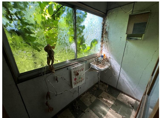
↑ 窓ガラスに割れあり
