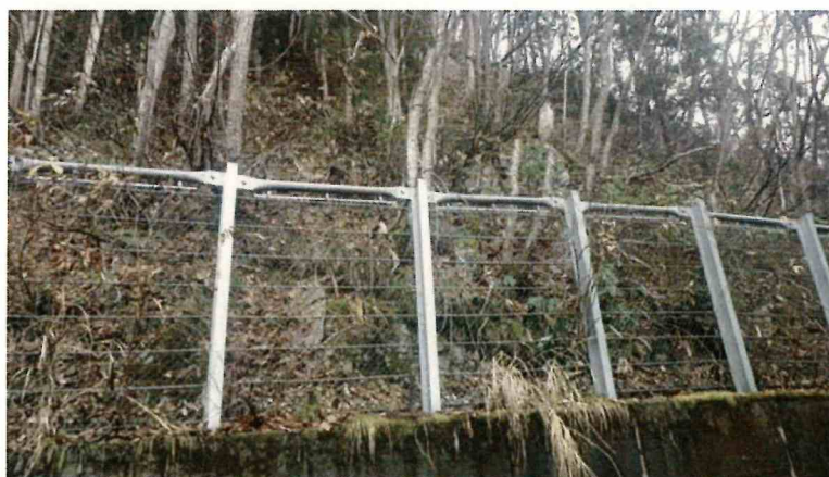
写真2 既設源泉北側村道切割法面露頭 巨大な転石の可能性もあるが、亀裂の多い安山岩がみられる。
