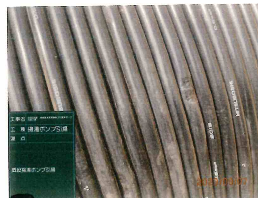
写真 4.1.6 低水位ケーブル外傷
