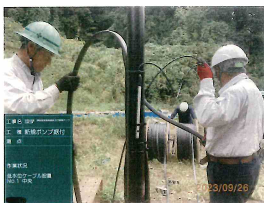
写真 4.2.5 低水位 No.1 揚湯管中央
