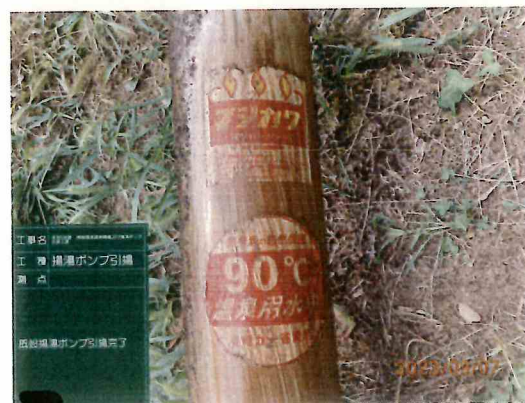
写真 4.1.4 揚湯ポンプ外観アップ
