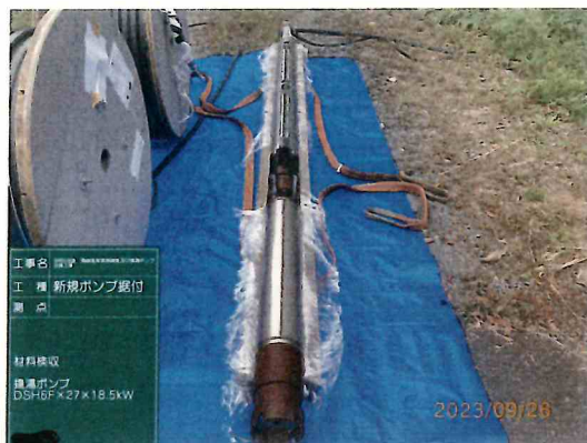
写真 4.2.1 新規揚湯ポンプ外観
