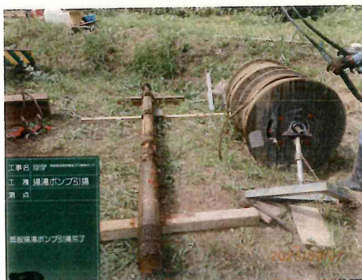
写真 4.1.3 揚湯ポンプ外観
