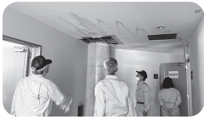
雨漏りにより損傷した天井
