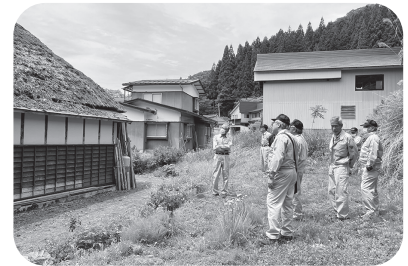
劣化が著しい北側
