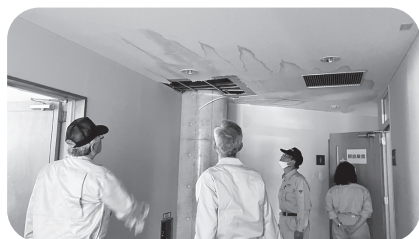
雨漏りにより損傷した天井
