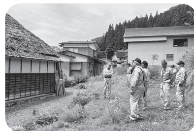
劣化が著しい北側
