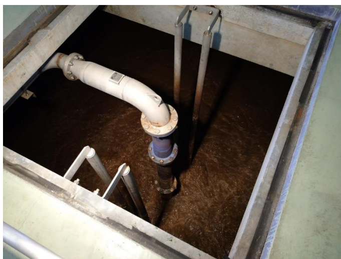
土木設備（回分槽）
